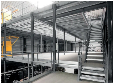
Fot. 1 - Antresola Magazynowa
